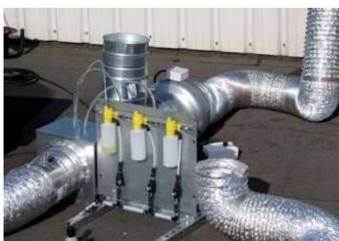
Figure 25 : Pilote de production de vapeur sèche
